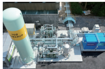
▲e-メタン製造実証設備(愛知県知多市)
