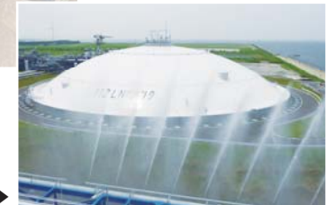
非常時に備えたLNGタンクの水幕設備▶
