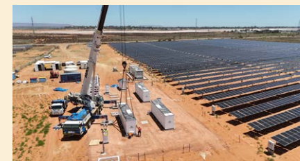
YES Groupが保有する太陽光発電所・蓄電池(建設中)
