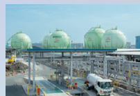
東邦液化ガス(株) 名港LPG基地
