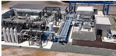
知多緑浜工場の水素製造プラント(2024年6月運転開始)
