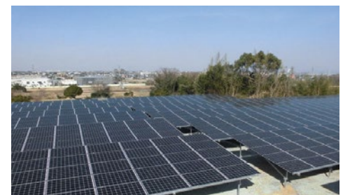
武豊町太陽光発電所
