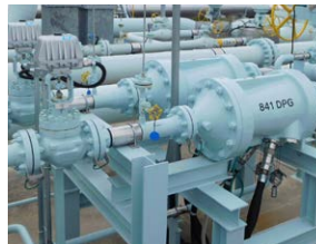
ガス差圧発電設備
