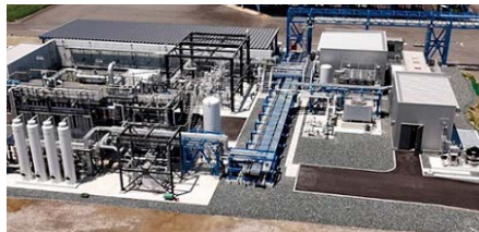
知多緑浜工場の水素製造プラント (2024年6月運転開始)
