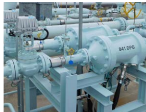
ガス差圧発電設備
