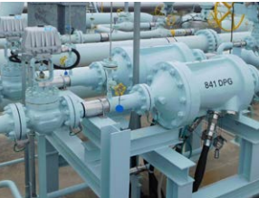
ガス差圧発電設備
