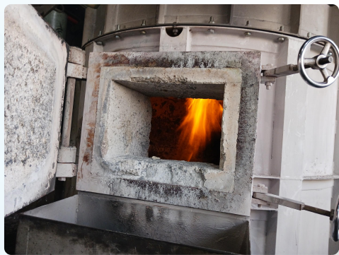
工業炉における都市ガスの燃焼
