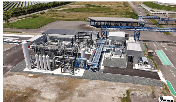
知多緑浜工場の水素製造プラント
