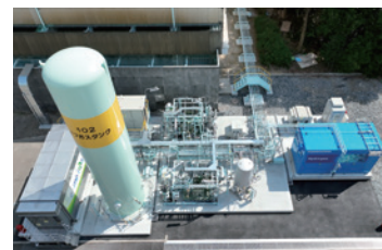
e-methane製造装置
