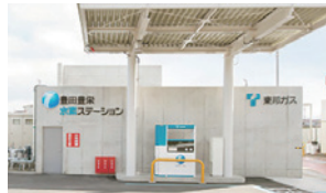
豊田豊栄水素ステーション
