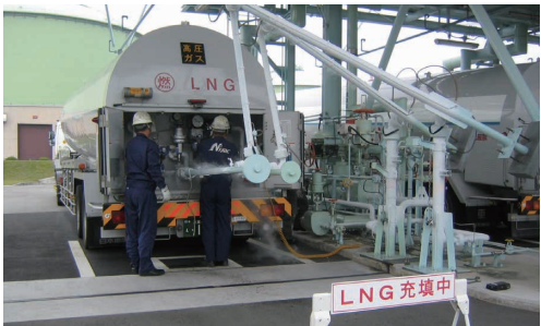
LNGローリー出荷設備
