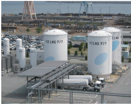
津LNGステーション
