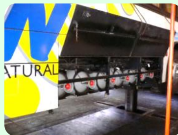
交換した新品CNGタンク (120L×6本)
