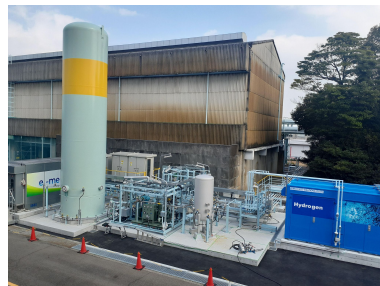
メタネーション実証設備(建設中)
