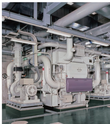
小牧駅西地域冷暖房プラント
