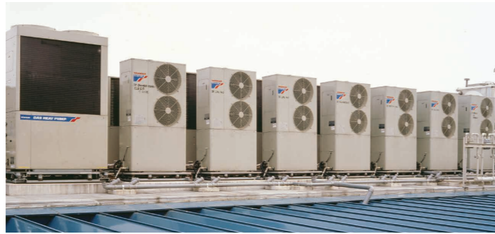
小型ガスヒートポンプの複数台設置(室外機)
