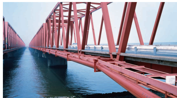
中圧A導管 名古屋～四日市線(木曾川横断部)
