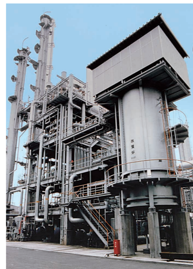
代替天然ガス(SNG)装置
